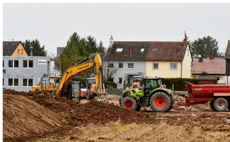
„In den Beeten II“ wird gebaut. Aus dem Grundstücksverkauf wird mit Einnahmen von 9,4 Millionen Euro gerechnet. Foto: Martin Kalb
